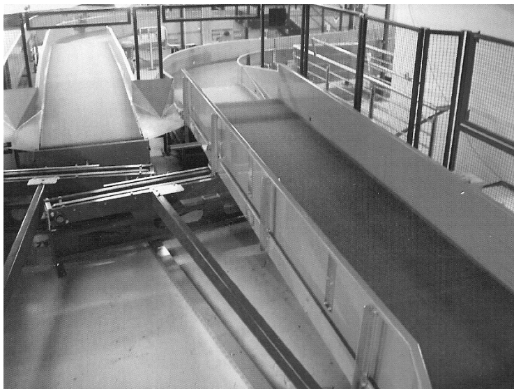
Rys.10. Urządzenie typu Horizontal diverter [6]
